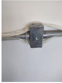
Ilustração: Ponto de rede RJ 45 instalado
