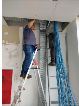
Ilustração: Sistema de lógica CAT6 com leito independente para passagem de rede alimentando 81 pontos Fonte: Relatório fotográfico referente a CAT (3002552/2023) da Camaleão Engenharia (anexada ao processo)
