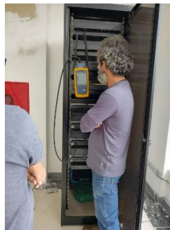
Ilustração: Análise de desempenho de performance rede CAT6 para certificação de MHz e transferência de dados Fonte: Relatório fotográfico referente a CAT (3002552/2023) da Camaleão Engenharia (anexada ao processo)
